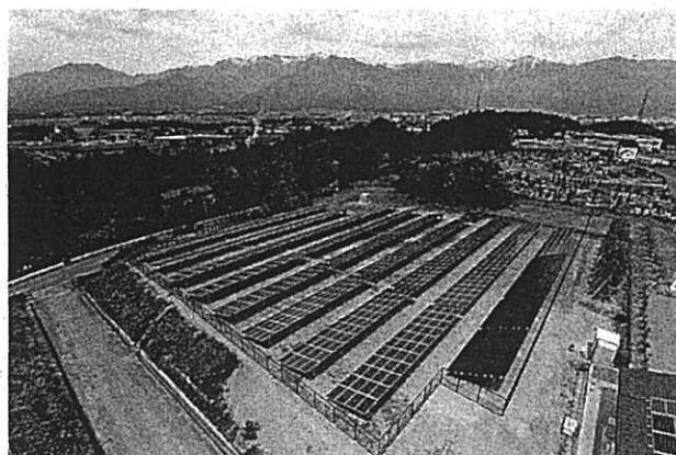
図表 56 リユース品を使用した発電所
