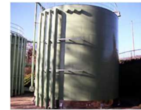
貯湯槽（保温後）
